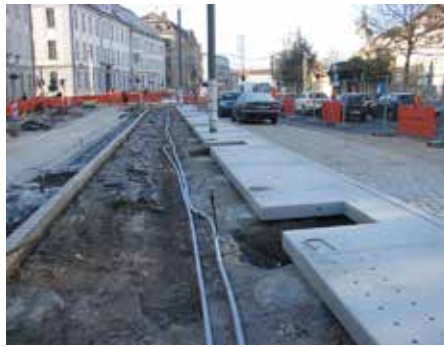
Verlegung eines der Hauptstränge, an denen die Tröpfchenbewässerungen für die Bäume angeschlossen werden.
