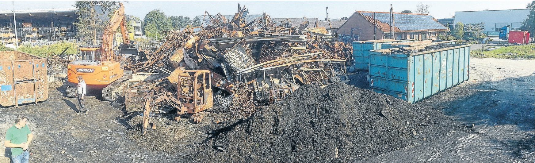
Die Brandstelle ist freigegeben, in dieser Woche haben die Aufräumarbeiten auf dem Gelände der Firma „Aqua-Technik“ an der Ulmenstraße (r.) begonnen.
